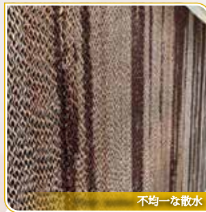
不均一な散水
